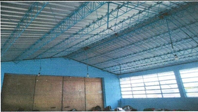
Foto 3: Sistema electrico en malas condiciones quebrados en einexistentes
