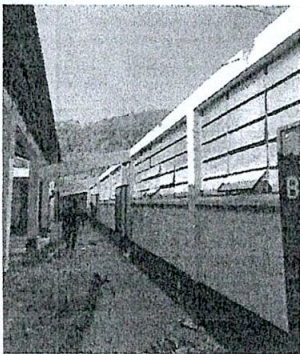
Foto 3: Todas las aulas sin techo
