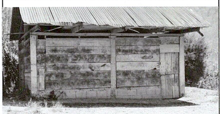
Foto 2: Pared y puerta en estado deplorable. (Necesidad de mejoramiento de pared y puerta)
