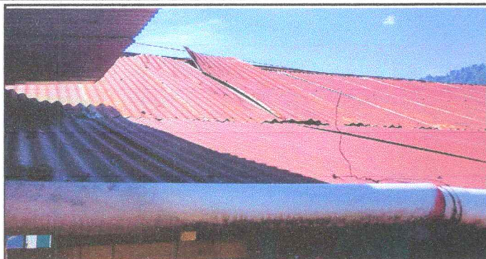
Foto 1: Techo de lámina en malas condiciones.
