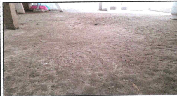
Foto 5: Piso en mal estado
