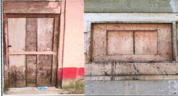
Foto 2: Puertas y ventanas en mal estado
