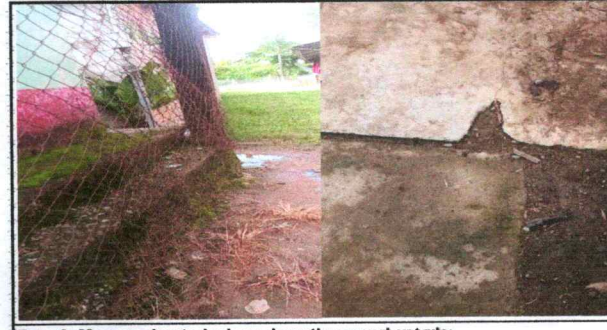
Foto 6: Muro perimetral y losa de patio en mal estado
