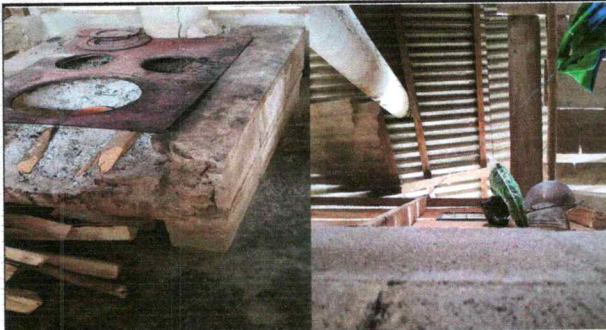
Foto 1: Plancha en mal estado y pared de madera en mal estado
