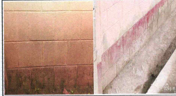
Foto 4: pintura y cuneta de concreto en mal estado
