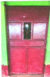
Foto1: Puertas en mal estado
