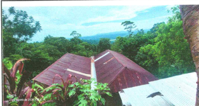
Foto 2: Cubierta de lamina en mal estado
