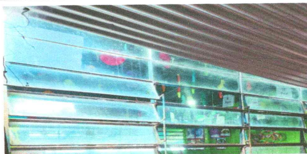
Foto 4: Ventana en mal estado
