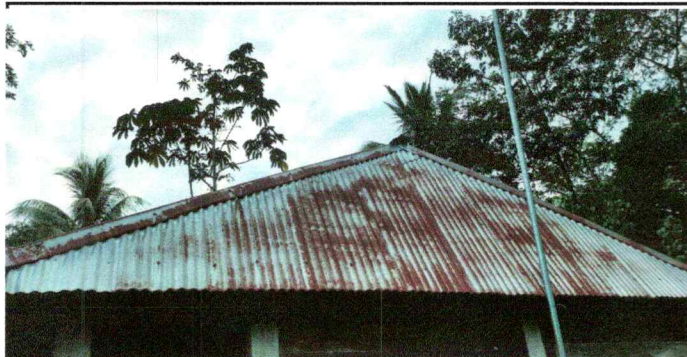
Foto 1: Sustitución de lámina, por lámina troquelada, Sustitución de elementos de fijacion, en cocina
