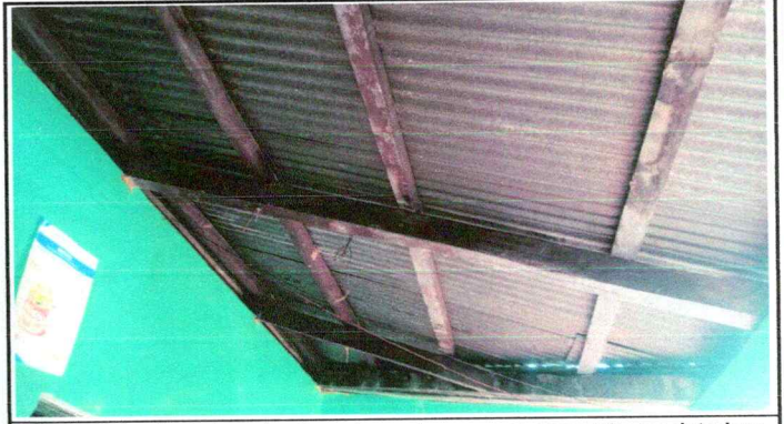
Foto 2: Cambio de la estructura de madera que se encuentra en deterioro total.
