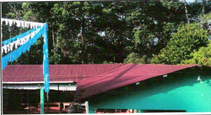
Foto1: Techo escolar. Cambio de la estructura del techo por desgaste en su totalidad.
