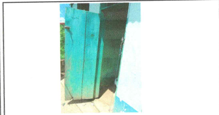
Foto 3: Se observa el deterioro de las puertas de los baños existentes del Módulo III de aulas, las cuales serán sustituidas por puertas de metal.
