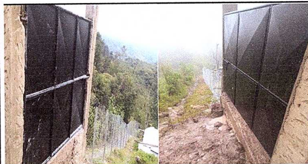
Foto 5: muro perimetral en mal estado
