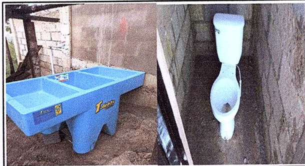
Foto 3: pila y baños en mal estado
