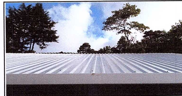
Foto 6:techo de aulas en mal estado
