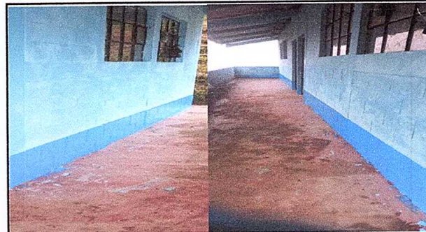
Foto 4: pintura en mal estado
