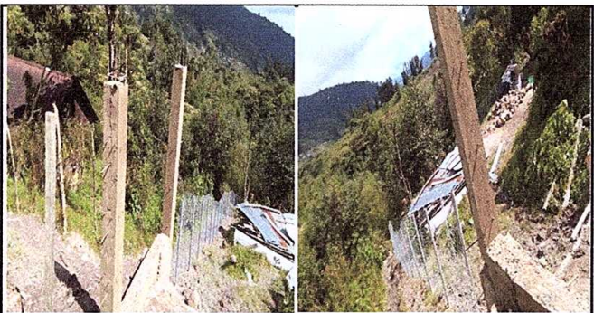
Foto 5: muro perimetral en mal estado
