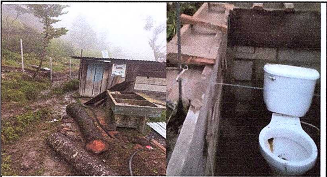
Foto 3: pila y baños en mal estado
