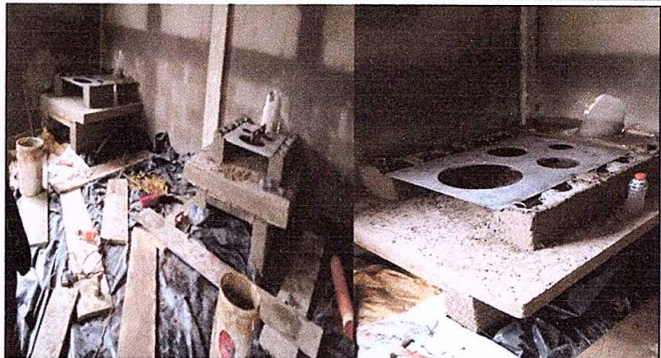
Foto 2: plancha en mal estado
