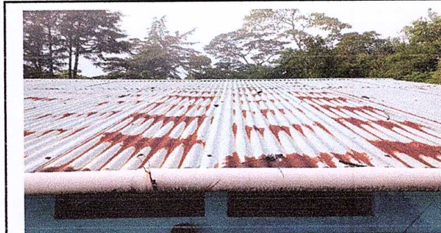
Foto 6: techo de aulas en mal estado
