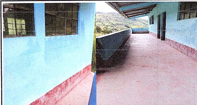
Foto 4: pintura en mal estado
