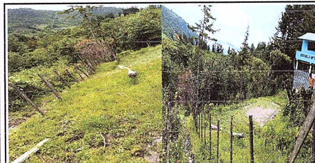
Foto 5: muro perimetral en mal estado
