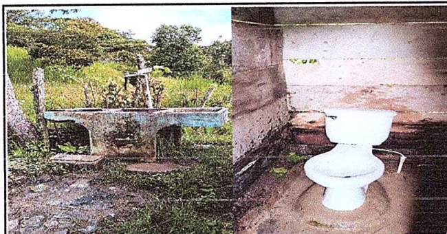
Foto 3: pila y baños en mal estado
