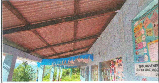
Foto 2: ESTRUCTURA DE TECHO. Sustitución de soporte de estructura de madera por metal
