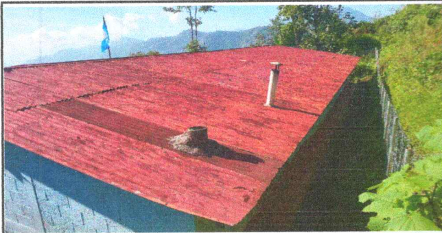
Foto 1: CUBIERTA DE LÁMINA. Láminas en malas condiciones
