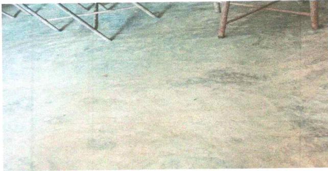
Foto 7: SUSTITUCION DE PISO POR MAL ESTADO
