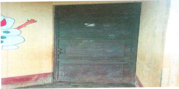
Foto 3: MANTENIMIENTO A PUERTAS POR MAL ESTADO
