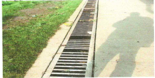
foto2: REPARACIÓN DE CUNETETA EN MAL ESTADO
