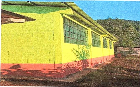
Foto No. 5 Pintura de pared.
