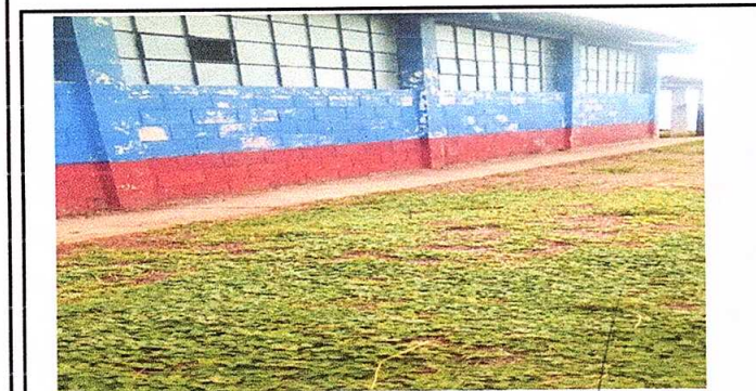
Foto No. 5 pintura de pared
