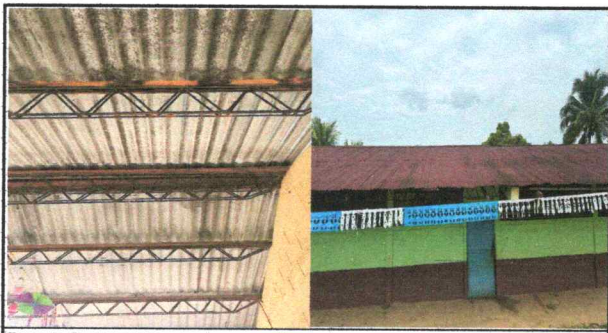
Foto 5: Costaneras y techo en mal estado
