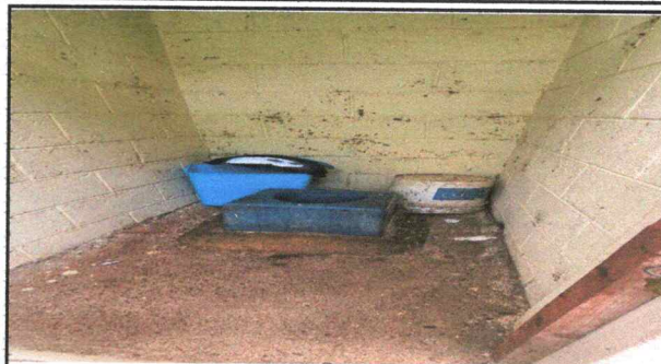
Foto 2: Inodoro en mal estado
