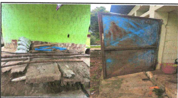
Foto 6: Piso y Puertas en mal estado
