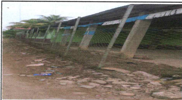
Foto 3: Muro perimetral en mal estado
