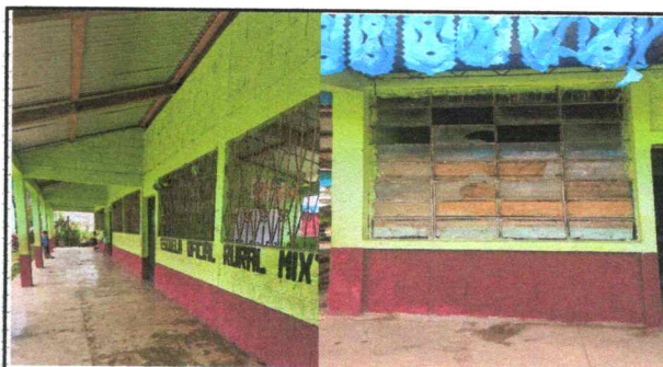
Foto 4: pintura y ventanas en mal estado
