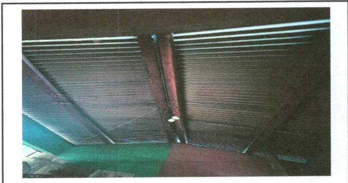
Foto 1: SUSTITUCION DE LAMINAS PARA 1 COCINA EN MAL ESTADO
