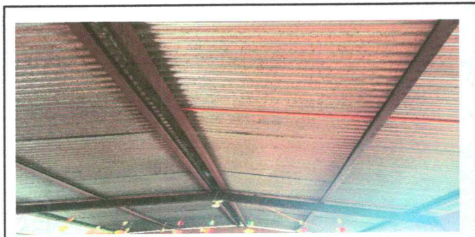
Foto 3: MANTENIMIENTO DE PINTURA PARA COSTANERAS DE 1 AULA EN MAL ESTADO
