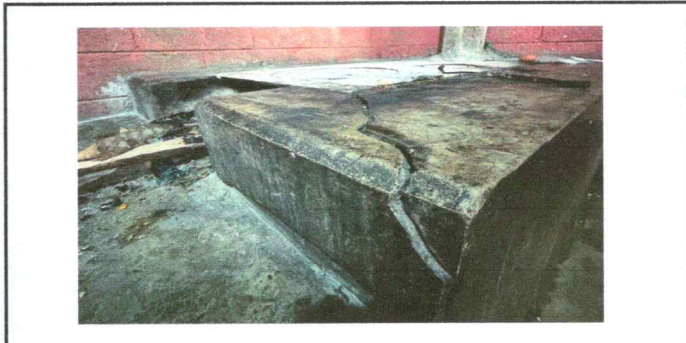
Foto 4: SUSTITUCION DE PLANCHAS DE LA COCINA EN MAL ESTADO
