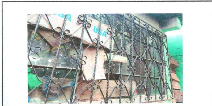
Foto 6: BALCONES DE 3 AULAS EN MAL ESTADO
