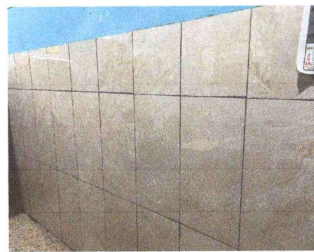
Foto 4: Sustrucción de repello de pared por azulejos
