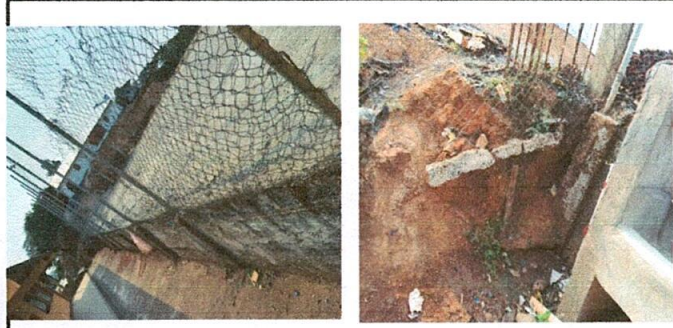
FOTO No. 7: El perimetro de la circulación y muro esta en malas condiciones.
