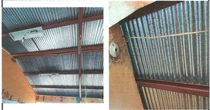
FOTO No. 8: el cableado del sistema electrico de las aulas y cocina estan en mal estado.
