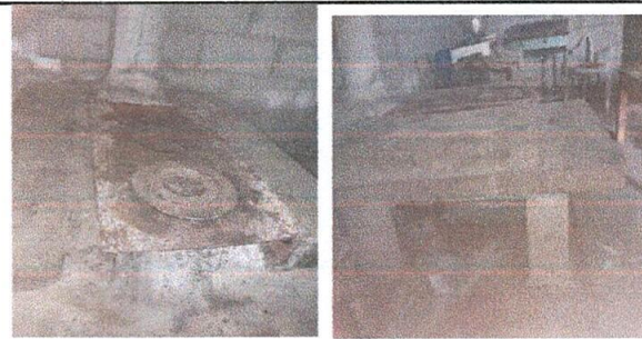
FOTO No. 10: la plancha y la estufa rural estan en malas condiciones.
