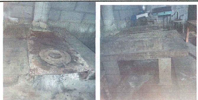
FOTO No. 10: la plancha y la estufa rural estan en malas condiciones.
