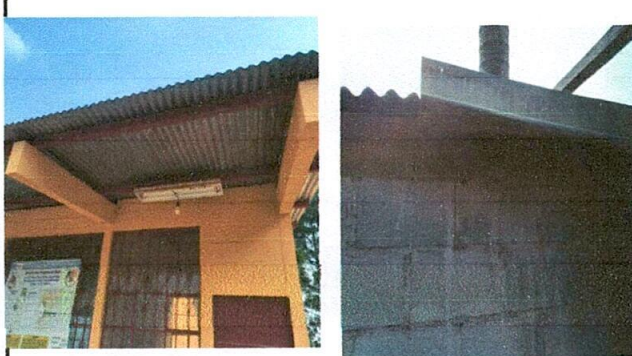
FOTO No. 3: los canales están en mal estado
