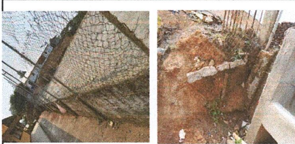
FOTO No. 7: El perimetro de la circulación y muro esta en malas condiciones.
