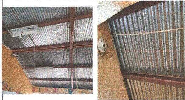
FOTO No. 8: el cableado del sistema electrico de las aulas y cocina estan en mal estado.
