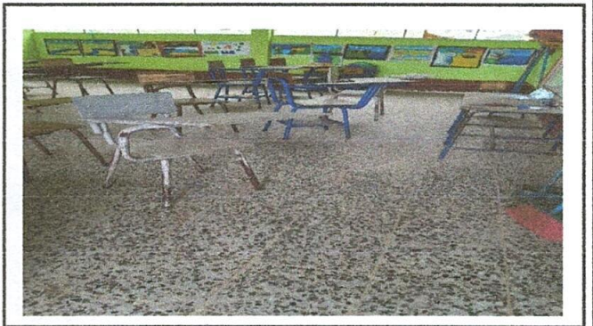
Foto 2: Condiciones de las aulas
