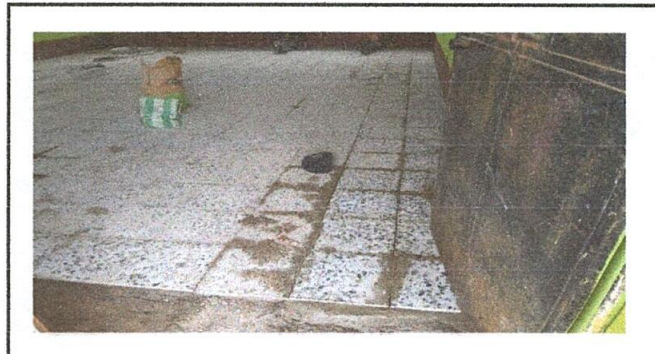
Foto 2: Condiciones de las aulas
