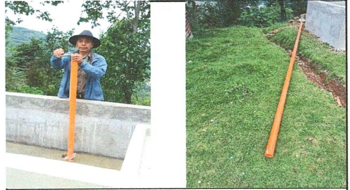
Foto 4: Sustitución de tubería PVC línea principal aguas negras y sustitución de llave de chorro
