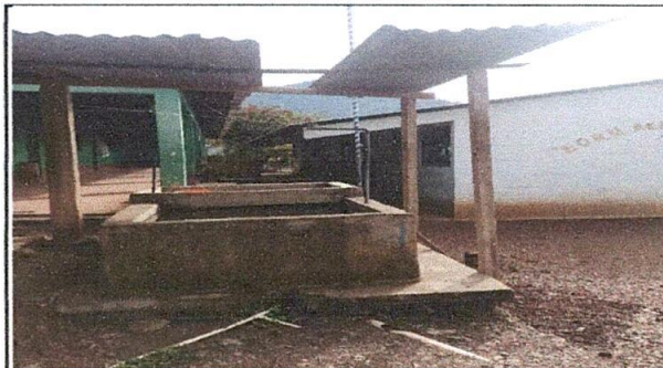
Foto 4. La pila está rota, su reposador está muy desgastado, sólo tiene una lavadora y el techo está en mal estado.
