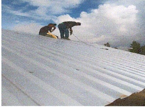
Foto1: LÁMINA DE COCINA
