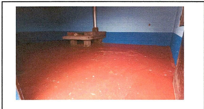
Foto 12: Sustitucion de estufa rural y piso de torta de concreto en cocina.
