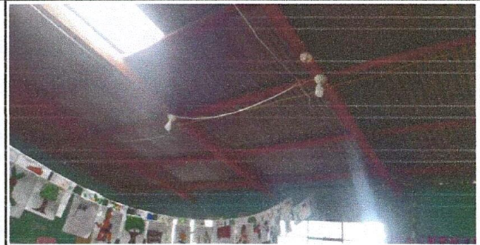
foto 10. Focos led instalados
