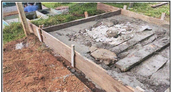
Foto 4: Construcción de base para instalación de depósito plástico para almacenamiento de agua.
