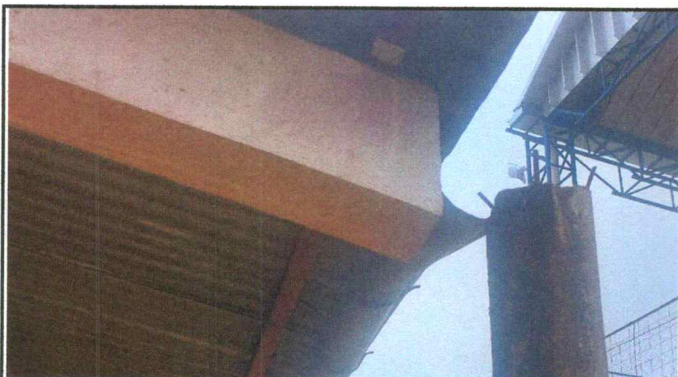
Foto 3: Falta de caídas de agua pluvial.
