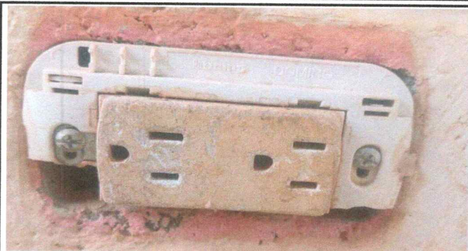
Foto1: Tomacorrientes y apadores en mal estado
