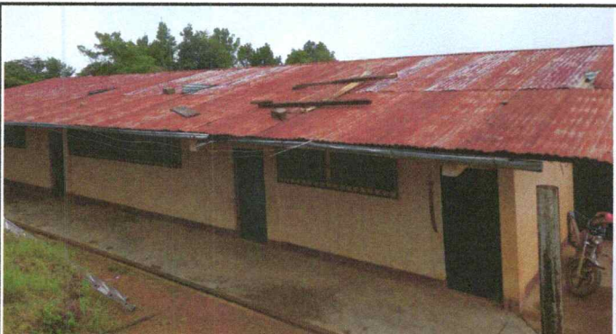
Foto 3: Techo con filtración, corroido por la oxidación.
