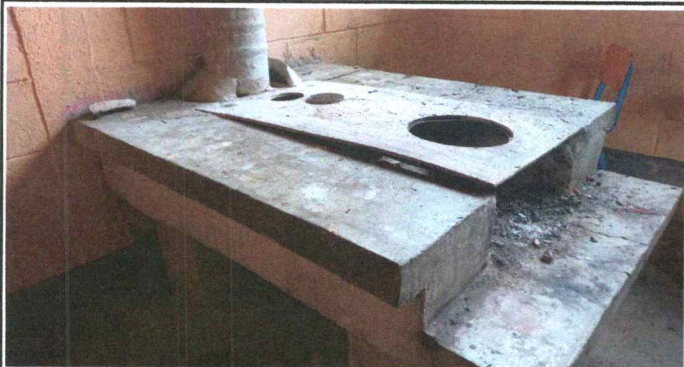
Foto 1: Plancha en mal estado
