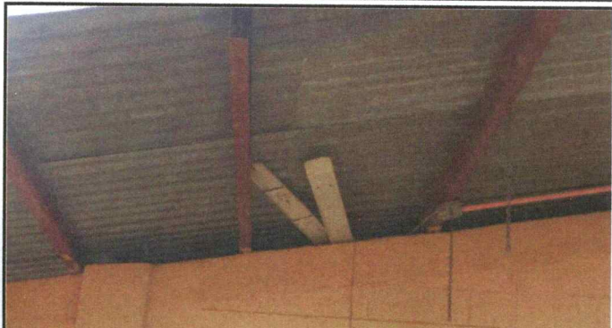
Foto 2: Sistema electrico inservible, lamparas fundidas
