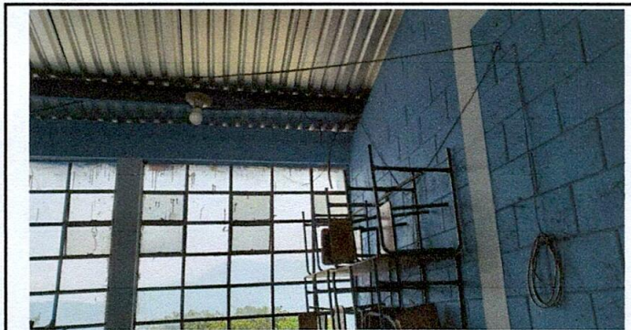
Foto 5: Instalación de luz improvisado y en mal estado del edificio escolar.
