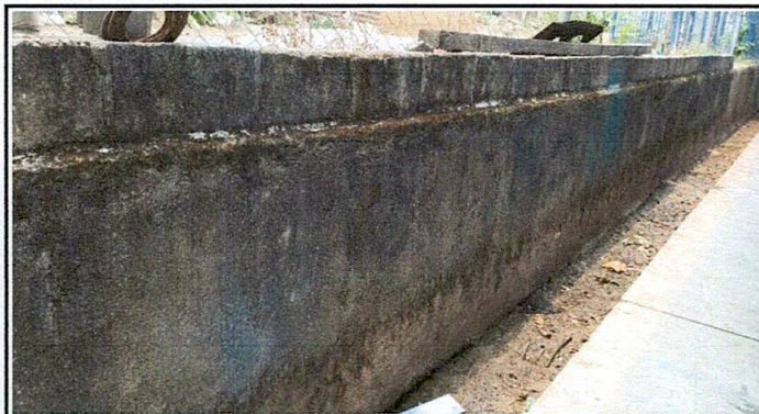
Foto 3: Muro de contención en mal estado que necesita ser remodelado.
