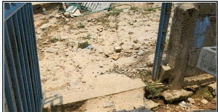
Foto 6: Banqueta de ingreso al centro educativo en mal estado y que necesita ser mejorado.
