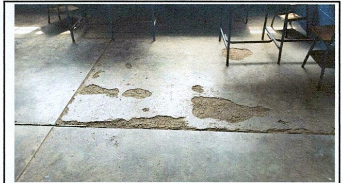
Foto 2: Pisos de torta de concreto en mal estado.
