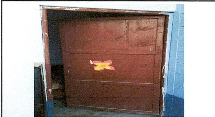
Foto 1: Se observa las puertas de madera en mal estado, con chapas deterioradas.
