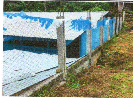
Foto 2: Reparación de muro perimetral de block con tubo hg y malla galvanizada, soleras intermedias y columnas.
