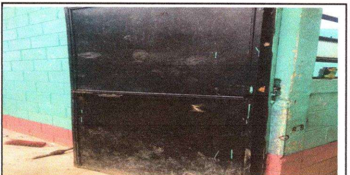
Foto 6: Sustrucion de pintura de puerta y chapa.
