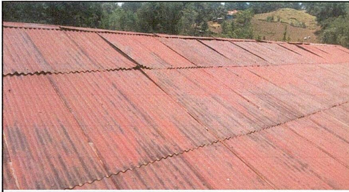
Foto 1: lámina en malas condiciones
