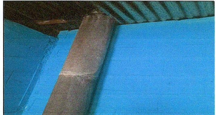
Foto 2: Sustrucción de techo de lámina por lámina troquelada color rojo y chimenea .
