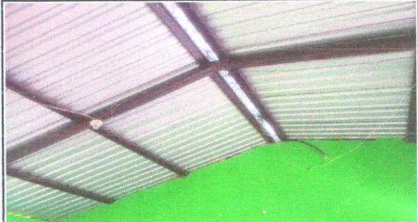
Foto 2: Mantenimiento de techo de metal en malas condiciones
