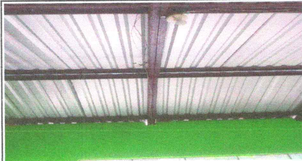
Foto 1: Laminas en malas condiciones y muchos agujeros
