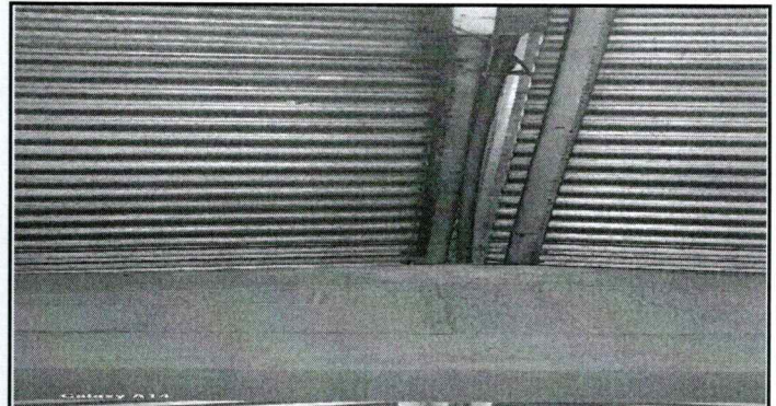
Foto 2: Sustitución de estructura de soporte de metal por metal , techo de la cocina.
