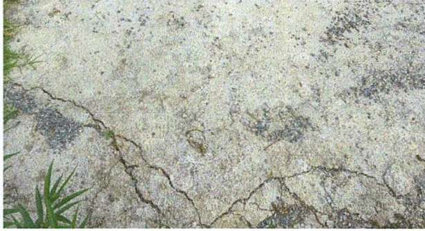
Foto 1: Patio de losa en mal estado.
