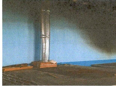
Foto 2: Paredes con pintura en mal estado
