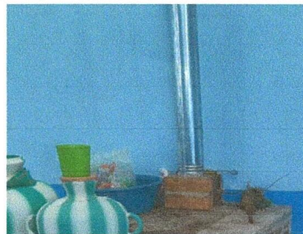
Foto 6: Chimeneas de metal frágil
