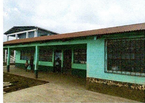
Foto 2: Pintura en mal estado
