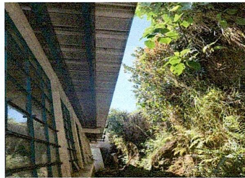
Foto 4: Cuneta en mal estado.
