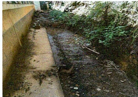
Foto 6: Cunetas en mal estado
