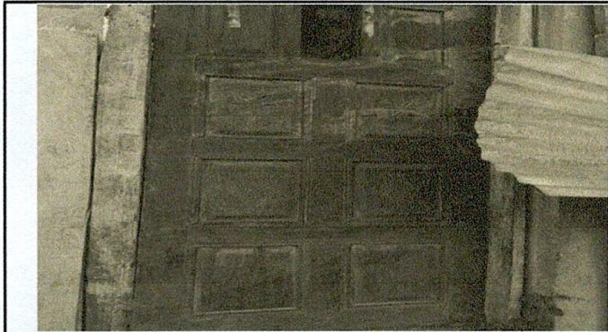
Foto 3: Puertas en mal estado
