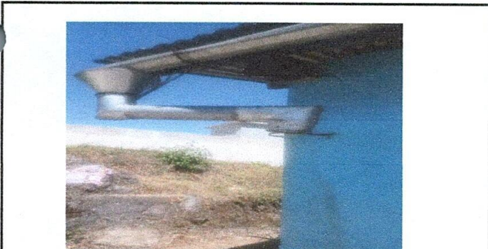
Foto 5: Bajadas de agua pluvial ya deteriorada.
