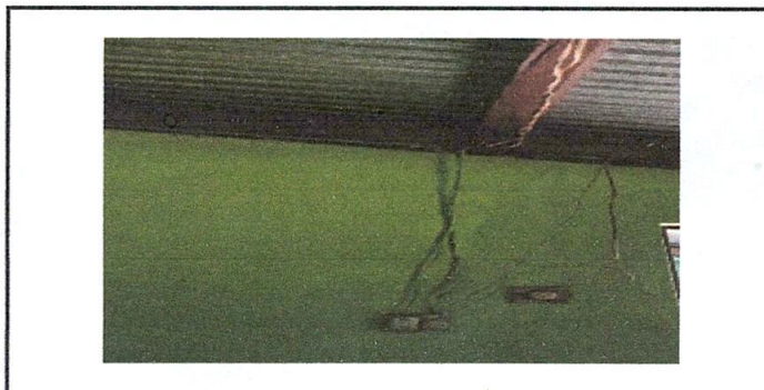
Foto 6: Cableado eléctrico en mal estado.
