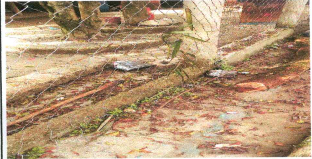
Foto 6. Malla en mal estado
