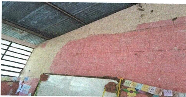
Foto 3: Paredes que necesitan pintado
