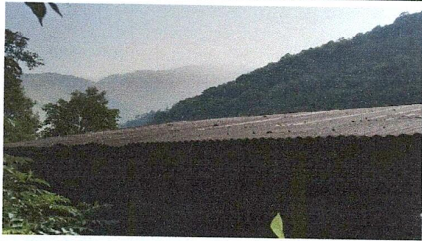
Foto 1: Láminas en mal estado
