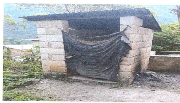
Foto 5: Sanitarios en mal estado.
