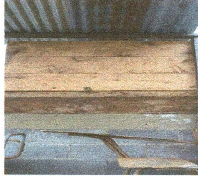
Foto 2: Deterioro de soporte de techo
