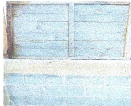
Foto 4: Ventanas en mal estado
