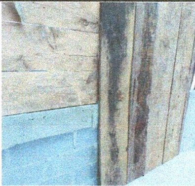
Foto 3: Puertas en mal estado
