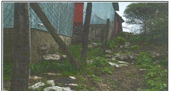
Foto 2: cercas en mal estado
