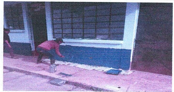
Pintura en mal estado
