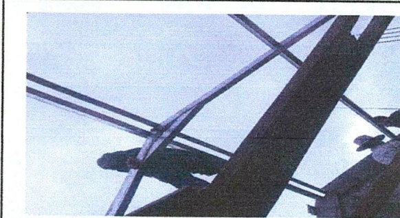
Foto 2: Deterioro de soporte de techo
