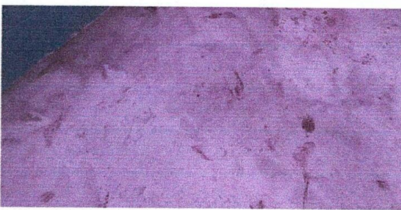
Foto 5: Piso en mal estado
