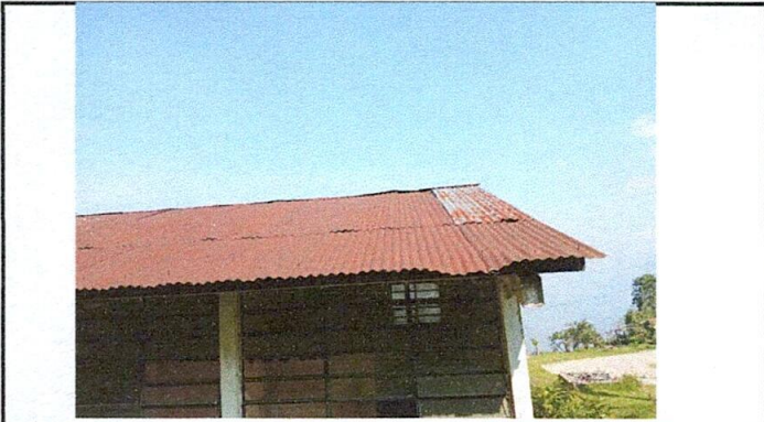
Foto 1: lámina en malas condiciones
