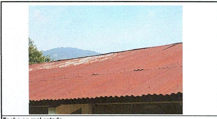
Techo en mal estado.
