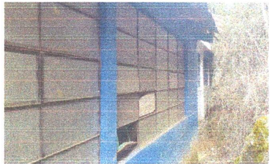
Foto 4: Deterioro de canales
