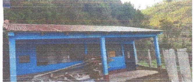
Foto 2: Pintura en mal estado
