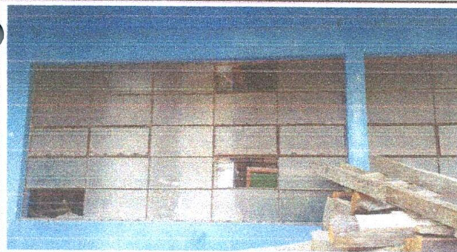
Foto 5: Ventanas en mal estado
