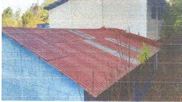
Foto 1: Deterioro de las láminas
