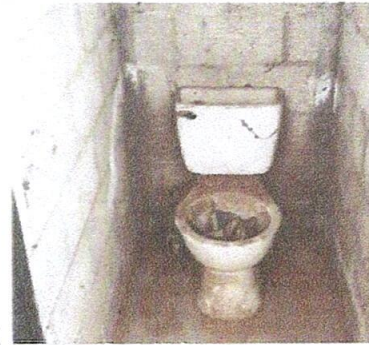
Foto: 4 inodoro inservible
