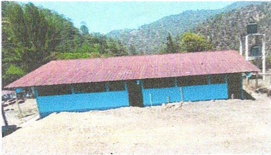
Foto: 1 Teja en mal estado
