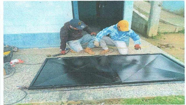
Foto 4: Sustitución de puertas en mal estado
