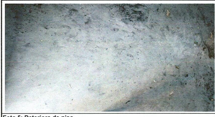
Foto 5: Deterioro de piso
